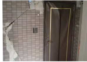
玄関ドア地震被害の例
