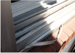
樹脂部分の脱落
