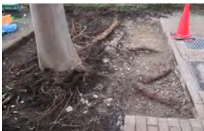
舗装を押し上げてしまった根
