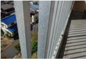
白い点錆が発生しているアルミ材
