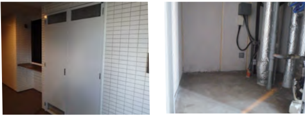
最近の建物の中には、広いパイプシャフトが設置されたものもある。写真は1系統分のパイプシャフトで、配管更新スペースがある。
