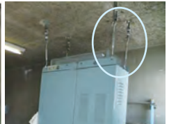
制御盤の転倒・移動防止
