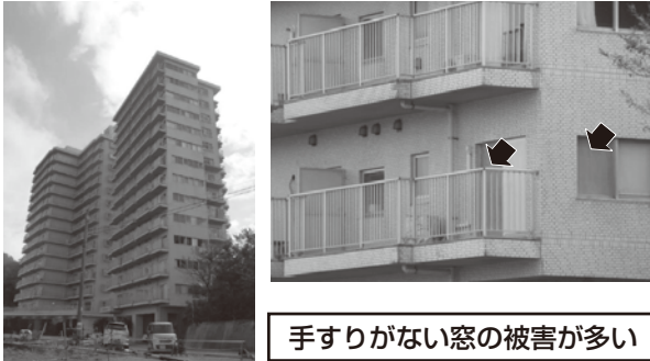
図9 飛来物により破損した窓ガラスの例
